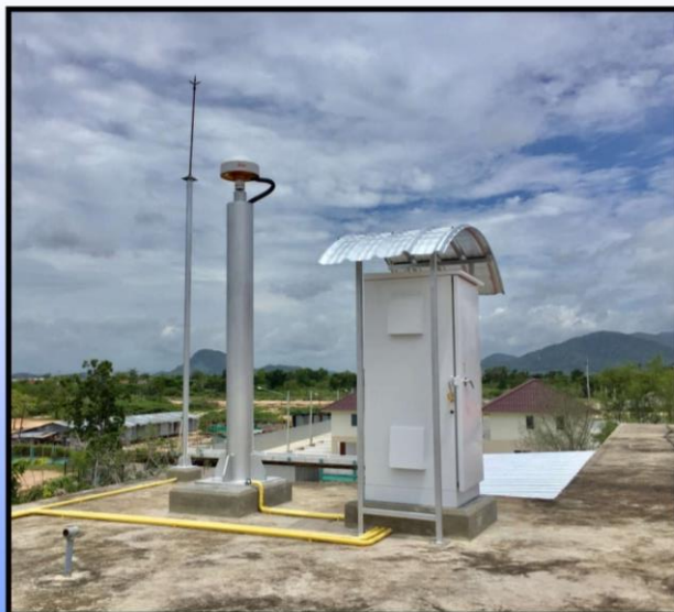
ติดตั้งบนอาคาร
